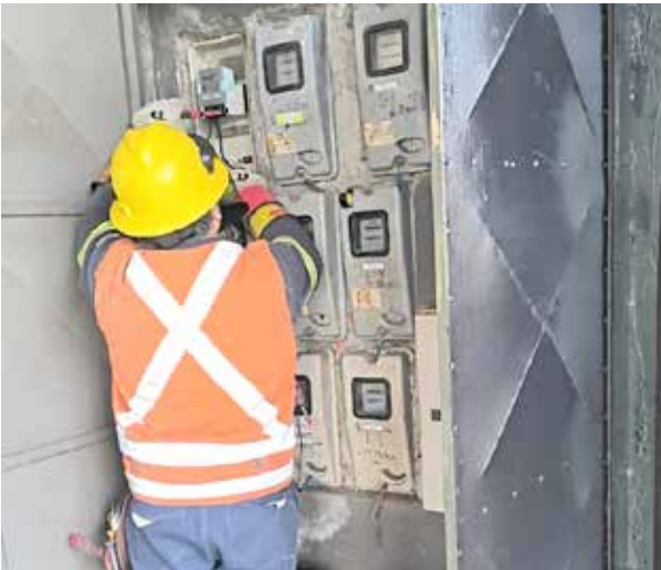
La continuidad del suministro eléctrico, la seguridad de las personas y el combate al delito de hurto de energía son objetivos permanentes en la labor que realiza la empresa de distribución eléctrica CGE.
